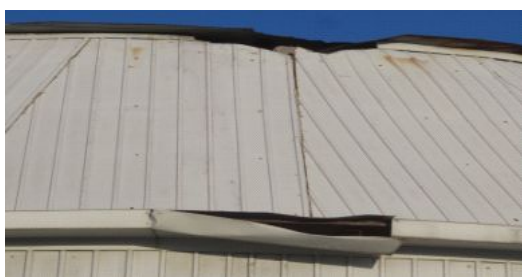
图 2 被坠冰砸坏的吸收塔保温层
