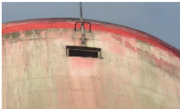
图 9：防冰装置安装后排口冬季运行情况
