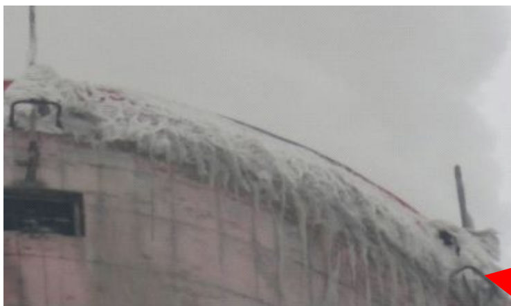
图 8：防冰装置安装前排口积冰情况
