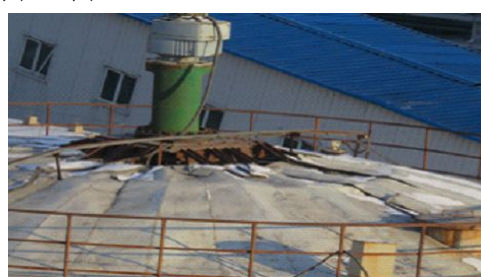
图 3 被坠冰砸坏的事故浆液箱顶部
