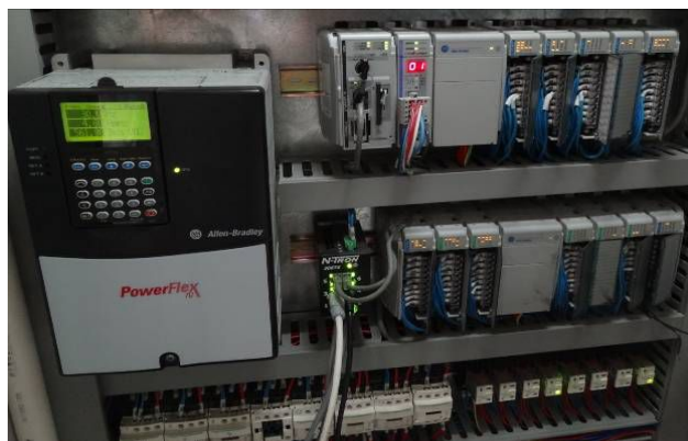
设备控制柜中的直通网络的交换机
